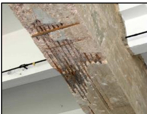
Figura 10: Viga de concreto sin recubrimiento
