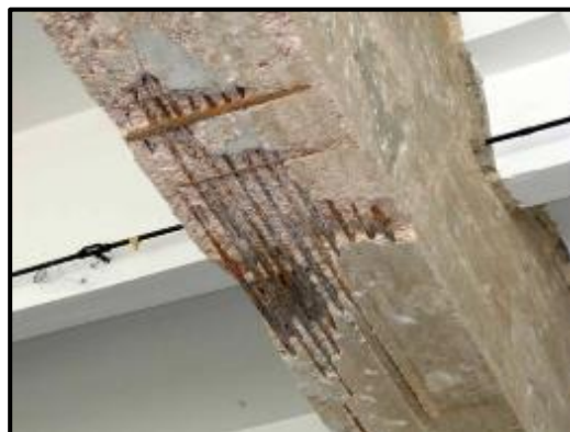
Figura 2: Viga de concreto sin recubrimiento
