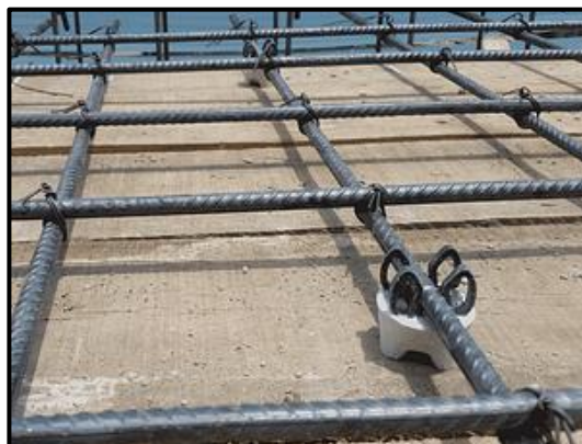
Figura 4: Separador de concreto acero de losa
