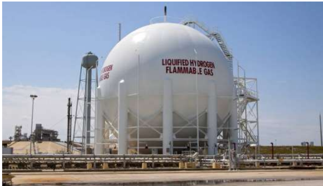
Figura 19 Almacenamiento de hidrógeno líquido
