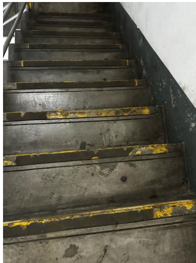
Ilustración 40: Demarcación de las señalización de escaleras
