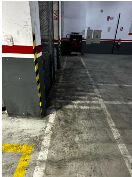
Ilustración 42: Pasillos y espacios de trabajo con grasa
