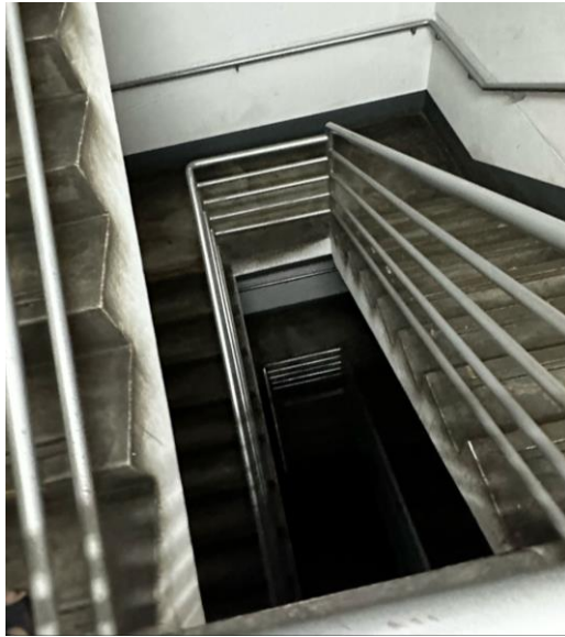
Ilustración 39: Falta de iluminación en sótanos
